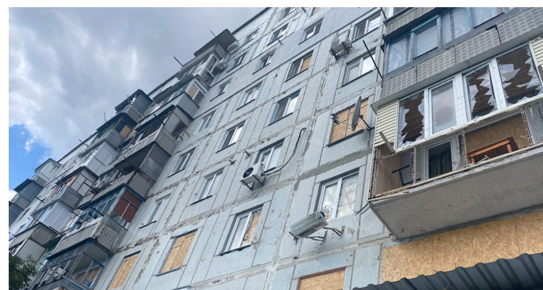
Building subject to Category II damage Photo provided by the municipality Будівля з пошкодженнями II категорії Фотографії муніципалітету
