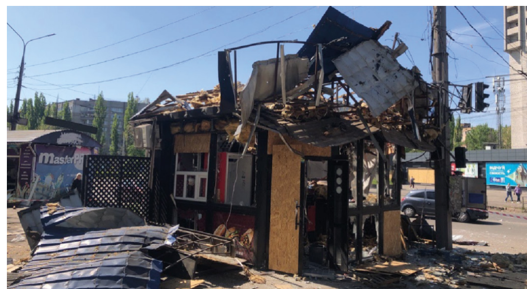
Building subject to Category III damage Photo provided by the municipality Будівля з пошкодженнями III категорії Фотографії муніципалітету
